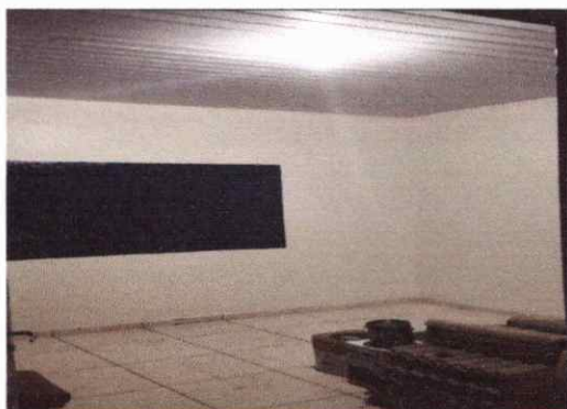
FOTO 45 INSTALAÇÕES ELÉTRICAS - LÂMPADAS
