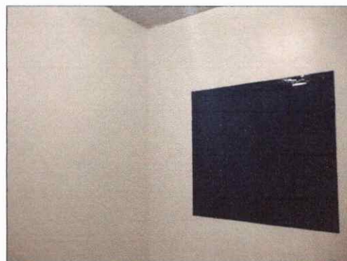
FOTO 46 INSTALAÇÕES ELÉTRICAS - LÂMPADAS
