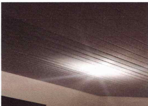
FOTO 43 INSTALAÇÕES ELÉTRICAS - LÂMPADAS
