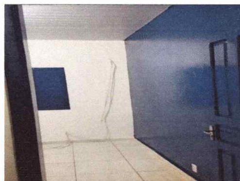
FOTO 48 INSTALAÇÕES ELÉTRICAS - LÂMPADAS
