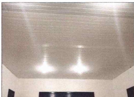
FOTO 47 INSTALAÇÕES ELÉTRICAS - LÂMPADAS
