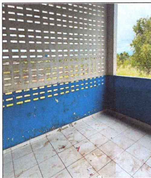
FOTO 92 ANTES DA MANUTENÇÕES
