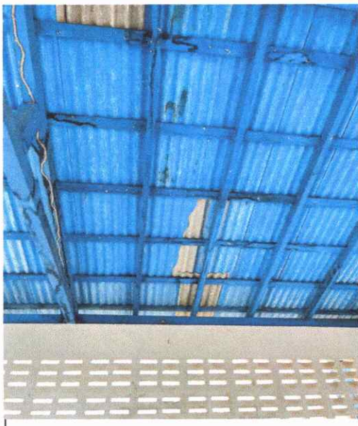
FOTO 91 ANTES DA MANUTENÇÕES
