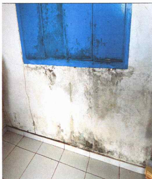
FOTO 93 ANTES DA MANUTENÇÕES
